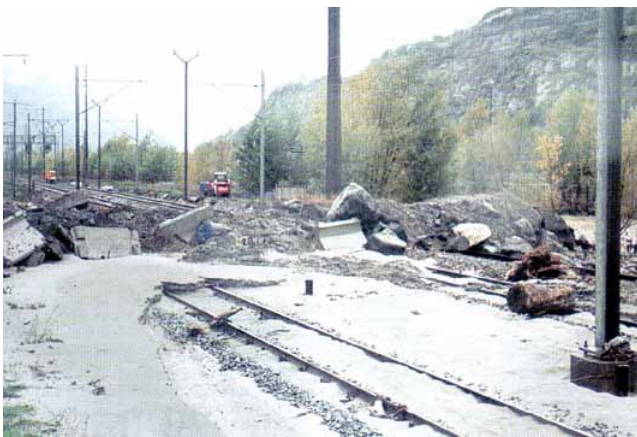
Oversvømmelsens omfang på BVZ- og SBB skinneanlægget mellem Brig og Visp den 16. oktober 2000.
